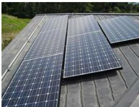
住宅用太陽光発電システム
